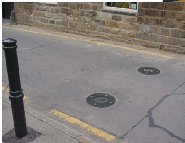
Figura 251 - Pilares retráteis que se elevam para restringir acesso 1
