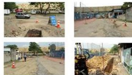
Sub-bacia DO1 – Vistoria de 30/09/2013
