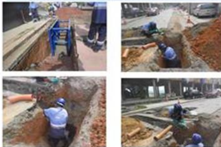
Sub-bacia DO1 – Vistoria de 18/11/2013
