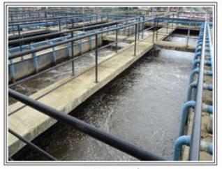
Vista de tanques de aeração.
