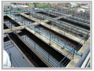
Vista geral dos tanques de aeração e dos decantadores secundários.
