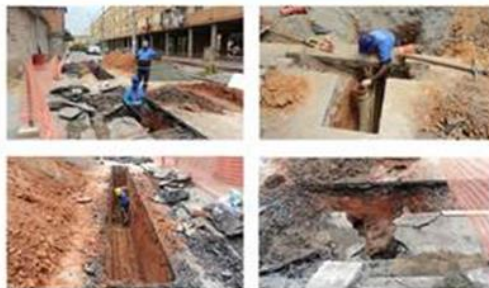
Sub-bacia DO1 – Vistoria de 30/10/2013
