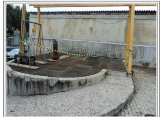
Vista da elevatória de entrada
