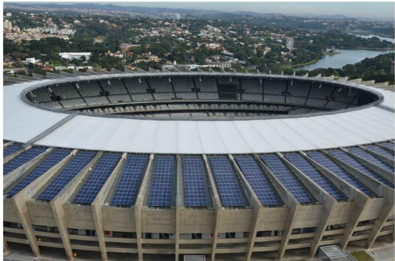
Painéis solares no Estádio do Mineirão - CEMIG
