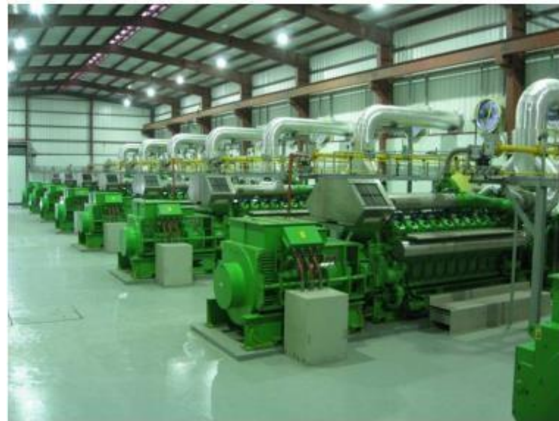
Geradores elétricos a Biogás – Foto GE Jenbacher
