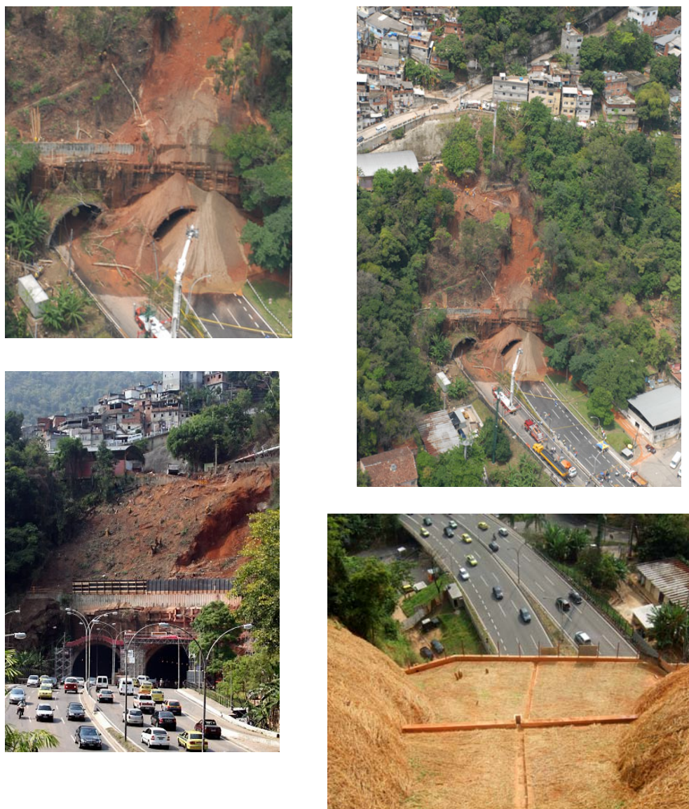
Figura 1: Galeria do Túnel Rebouças interditada após deslizamento e obras de contenção custeadas pelo Fundo de Conservação Ambiental da Cidade.
