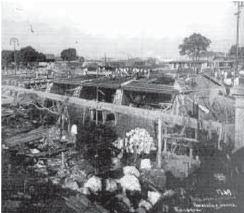
Construção de ponte sobre a foz dos rios Joana e Maracanã Foto Augusto Malta, 1/8/1922 FMIS/RJ
