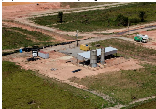
CTR-RIO – UNIDADE DE QUEIMA DO BIOGÁS (Fonte: COMLURB)
