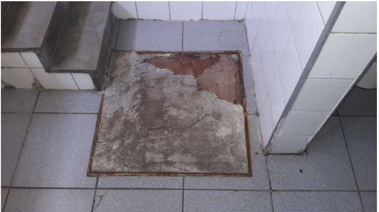
PISO DOS BANHEIROS INFANTIS COM CERÂMICAS A SEREM RECOLOCADAS E REJUNTE REFEITOS
