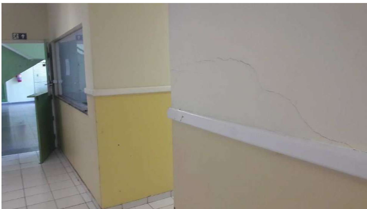
PAREDES INTERNAS COM FISSURAS A SEREM TRATADAS
