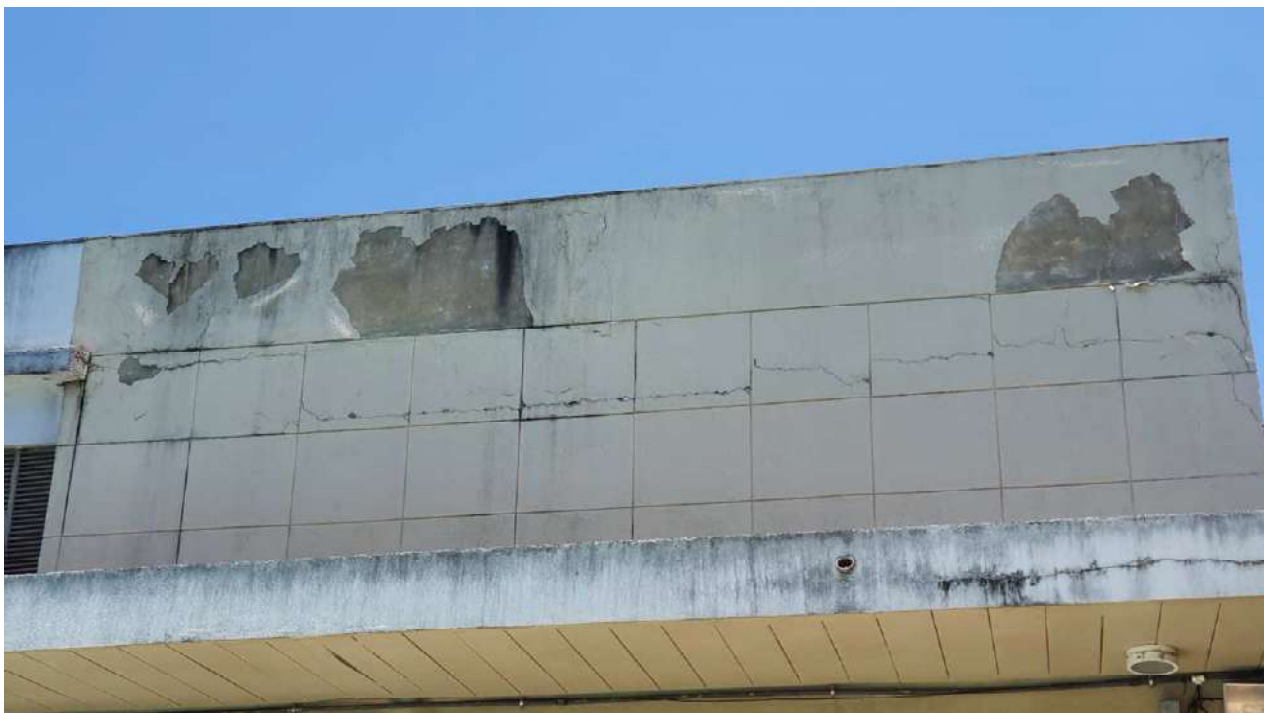
REVESTIMENTO DA FACHADA A SER RECUPERADO E PINTADO
