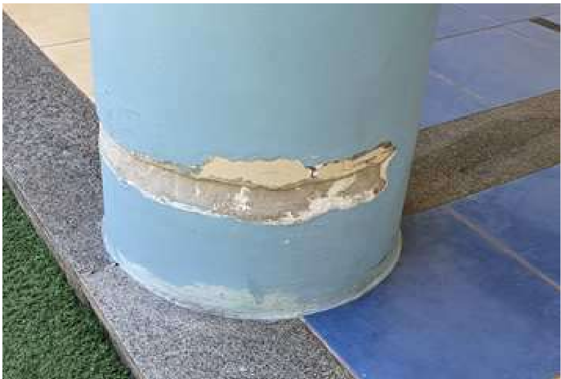
REVESIMENTO A SER RECUPERADO E PINTADO
