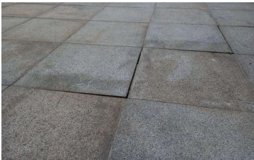
DETALHE DO PISO DESCOLADO
