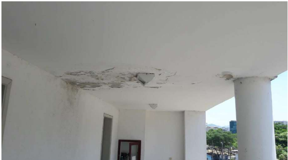
INFILTRAÇÃO NO FORRO DE GESSO SOBRE A VARANDA NO TERCEIRO PAVIMENTO PROVENIENTE DA LAJE ONDE ESTÃO INSTALADAS AS PLACAS DE AQUECIMENTO SOLAR A SEREM REMOVIDAS
