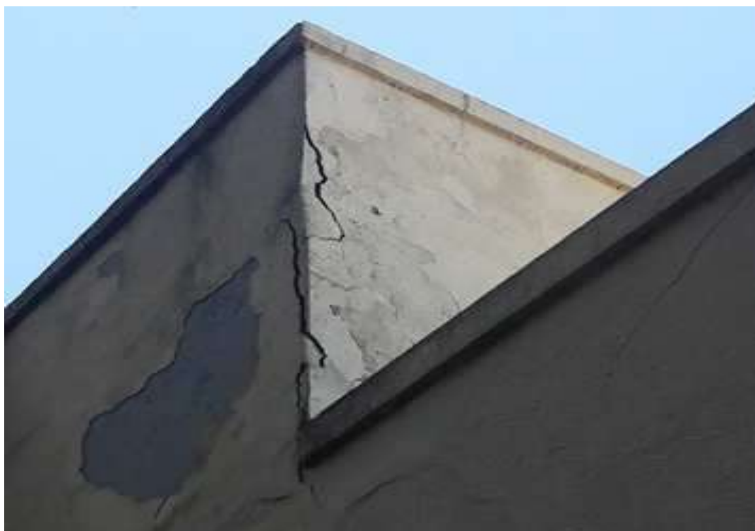
TRINCA E REVESTIMENTO NA FACHADA
