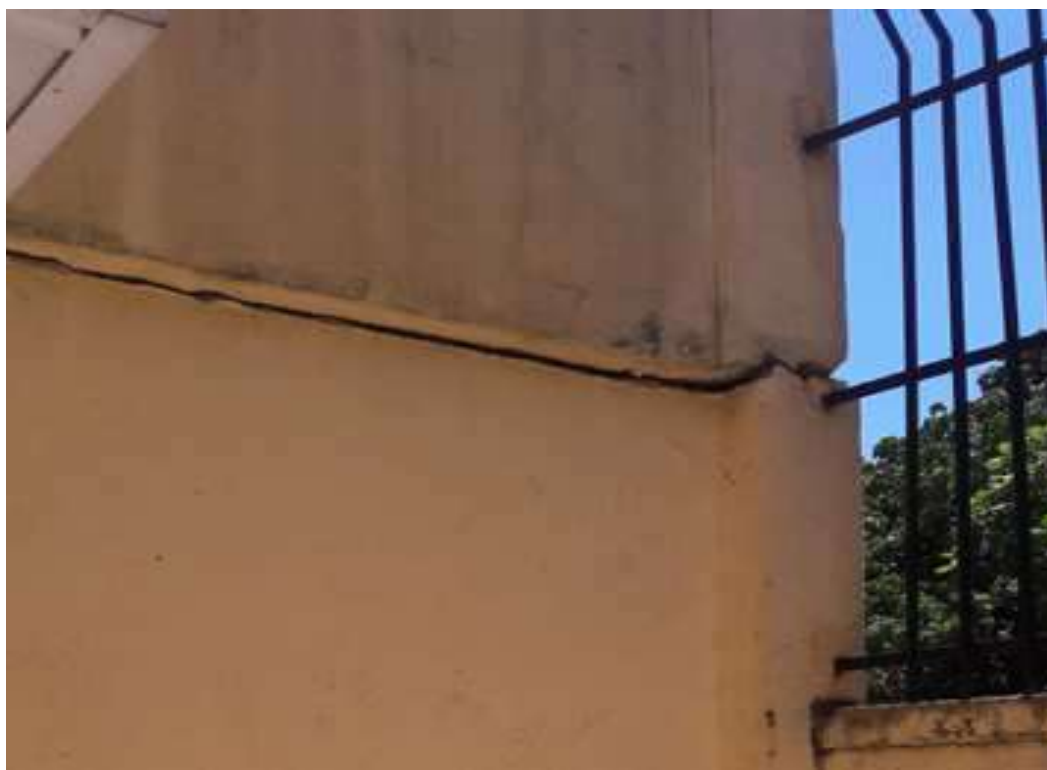
VIGA EM BALANÇO NO SOLÁRIO E PAREDE COM DESCOLAMENTO
