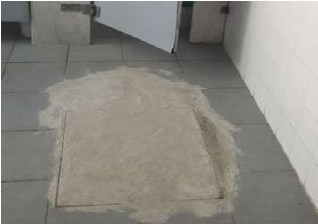
PISO NO VESTIÁRIO DOS FUNCIONÁRIOS A SER RECUPERADO
