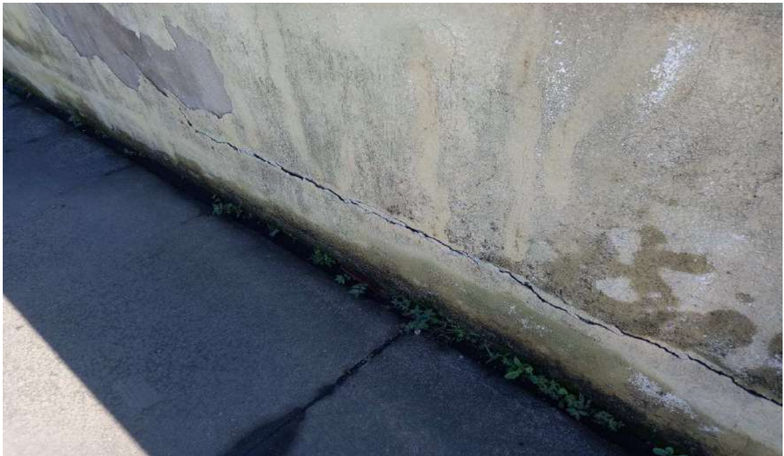
DETALHE DA MURETA TRINCADA PERMITINDO A INFILTRAÇÃO POR TRÁS DA MANTA
