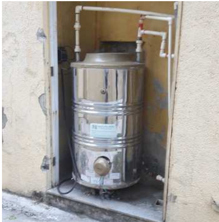
COMPARTIMENTO DOS BOILERS
