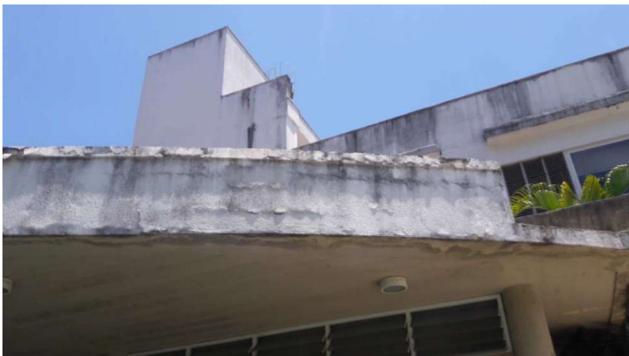
REVESTIMENTO INTERNO A SER RECUPERADO E PINTADO
