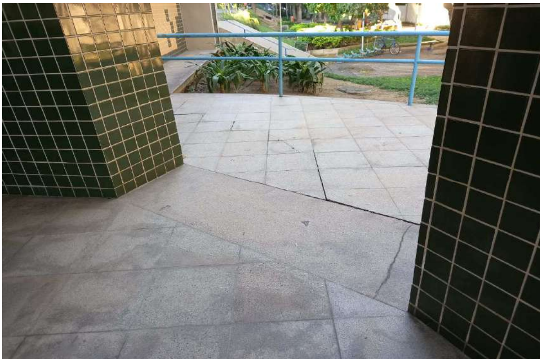
DESLOCAMENTO DO PISO DE GRANITO PROVOVADO PELO RECALQUE
