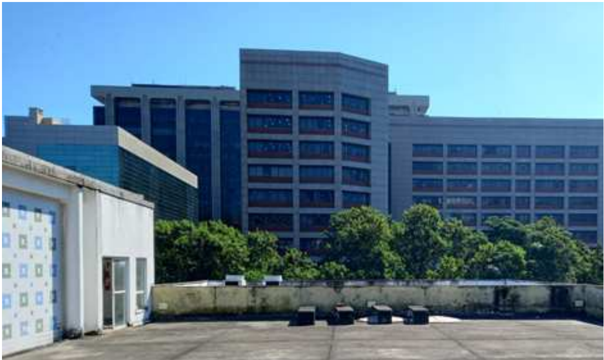
MURETA COM PONTOS DE INFILTRAÇÃO PARA PAVIMENTO INFERIOR.
