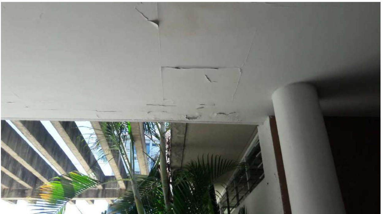
REBAIXO EM GESSO AS SER RECUPERADO E PINTADO
