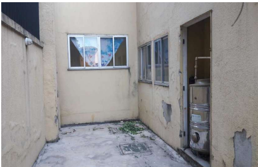
PISO DO SOLÁRIO COM RECALQUE E INFILTRAÇÃO PARA O SOLO
