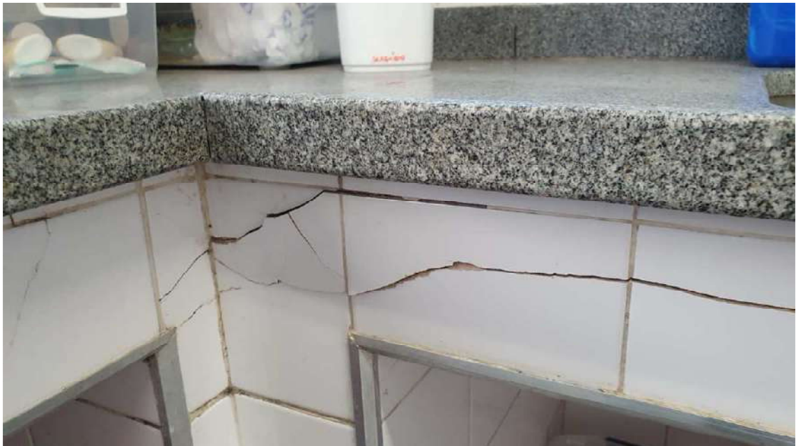
DETALHES DE CERÂMICAS COM FISSURAS E DESCOLAMENTO
