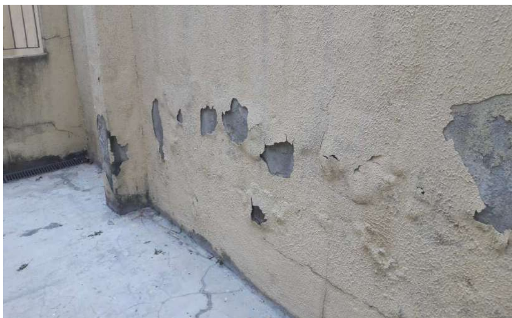
REVESTIMENTO DO SOLÁRIO A SER RECUPERADO E PINTADO
