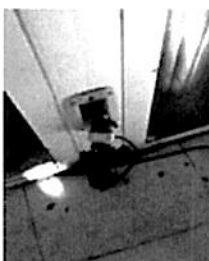
Figura 7 Exposição da fiação elétrica
