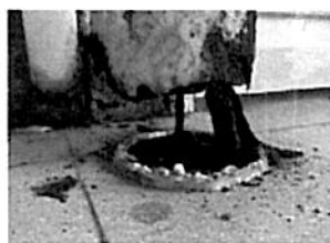
Figura 3 Desgaste da estrutura metálica
