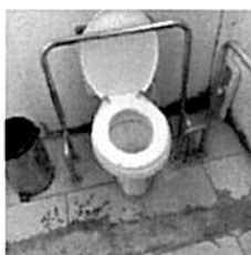
Figura 4 Instalações hidráulicas com vazamento e posicionamento incorreto do suporte
